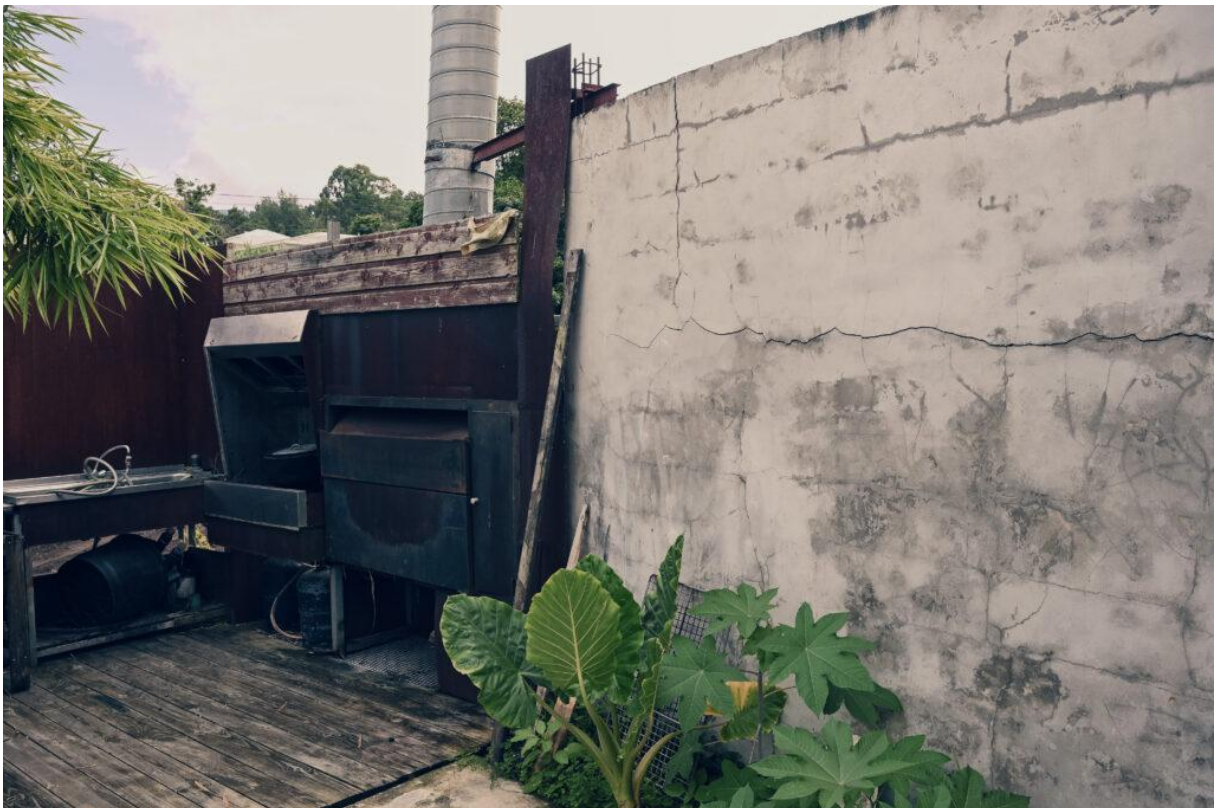
Sur le mur qui délimite son terrain, on peut voir de grosses fissures apparues suite au travail des engins de chantier.
