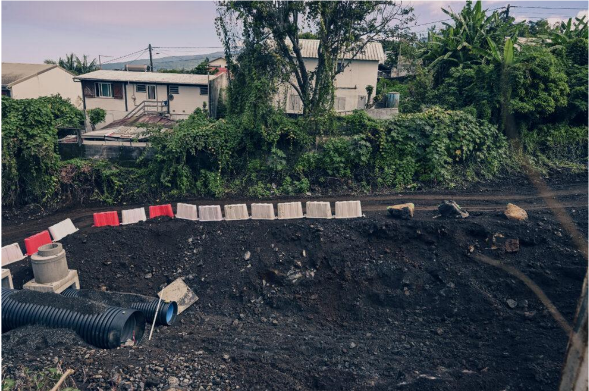
Sous sa terrasse, en lieu et place de la ravine et sa flore sauvage, il n'y a plus qu'une plaie béante.
