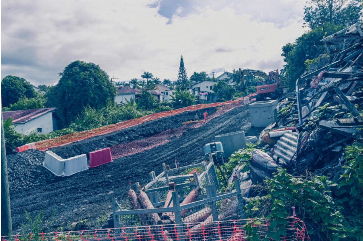
Un peu plus haut, on peut observer les travaux qui se continuent et notamment la forte pente de la future route.
